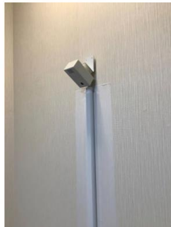
【居室トイレに設置】
